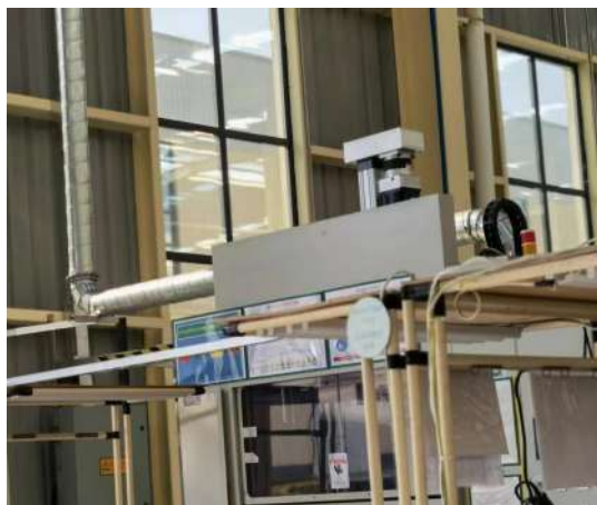
2#车间熔接废气收集管道
