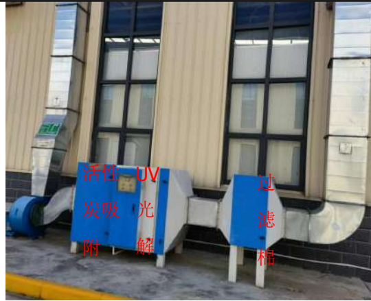
现有喷胶及新增 2100T 注塑机废气处理 (过滤棉+UV 光解+活性炭吸附)
