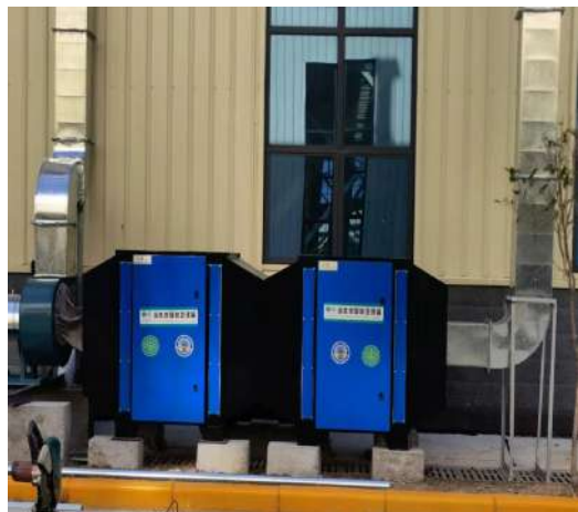
2#车间注塑废气处理设施（二级活性炭）
