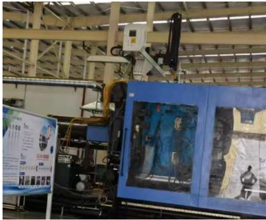
1#车间新增 2100T 注塑机废气收集
