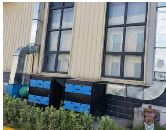
1#车间现有震动熔接废气处理 (二级活性炭)
